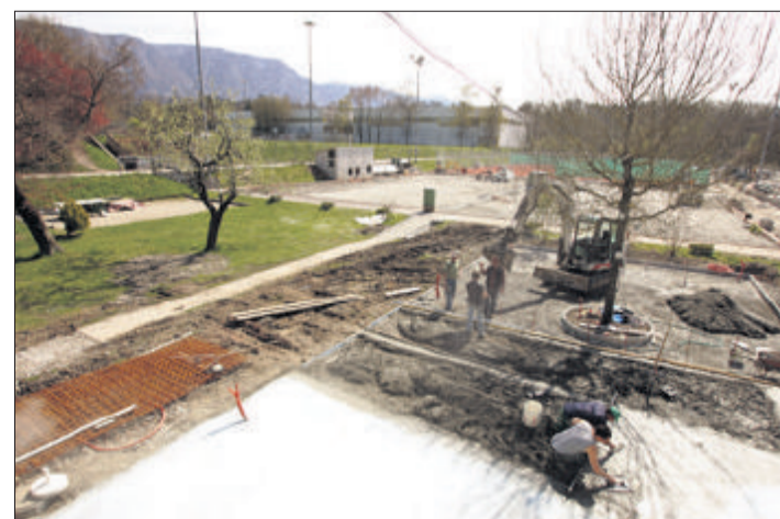
Travaux. Depuis le 4 décembre, le Drizia Miremont s'est transformé en un immense chantier, qui se terminera ces prochains jours. (GEORGES CABRERA)
